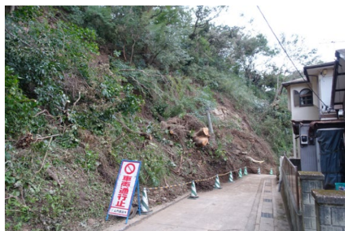
県有緑地における被害状況 (令和元年台風第 15 号)
