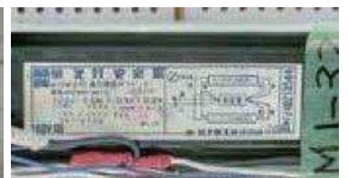
安定器部分の拡大
