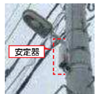
電柱への設置例
