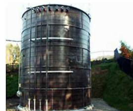
貯湯槽（保温前）
