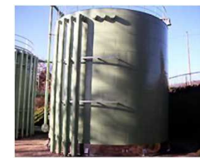
貯湯槽（保温後）
