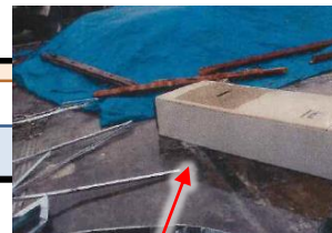
建物解体時にフロン類の回収がされず放置されている業務用エアコン
